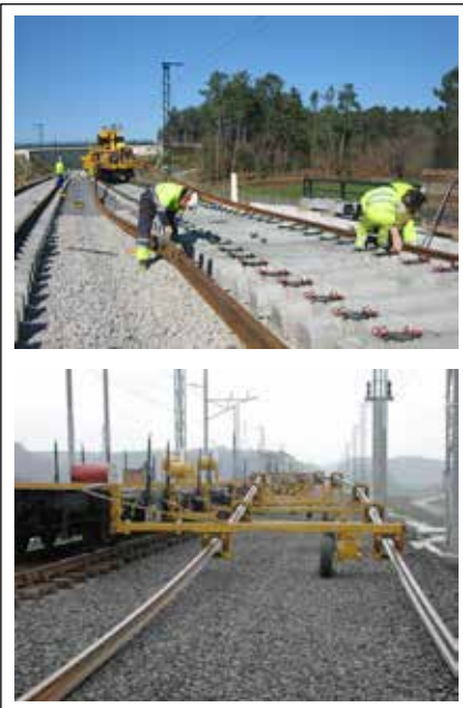
Figura 3. Descarga del carril.
