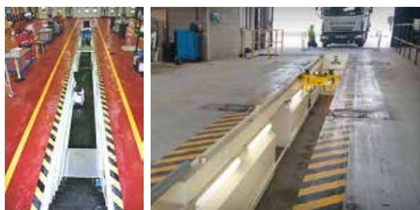
Figura 1. Foso de inspección de vehículos
