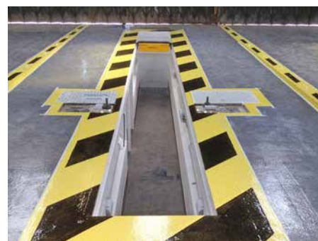
Figura 7. Bordes perimetrales del foso señalizados con bandas alternadas antideslizantes.
