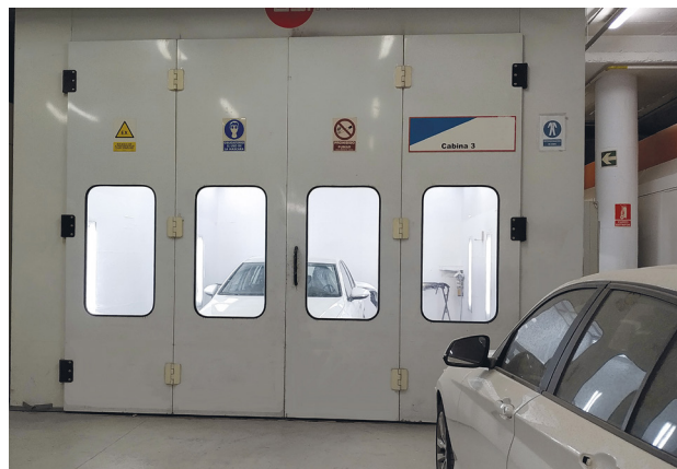
Figura 4: Cabina de pintura
