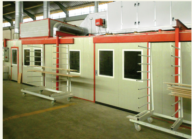
Vista general de un cabina de pintura
