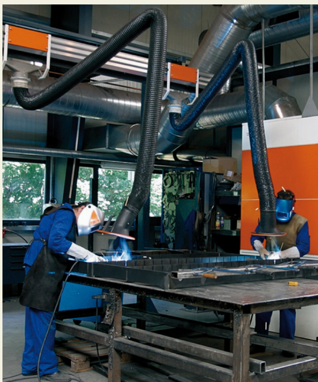
Equipo fijo de ventilación centralizado con varias tomas
