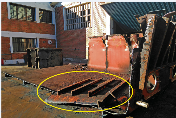
Figura 2: Pieza desplomada en el suelo tras el accidente
