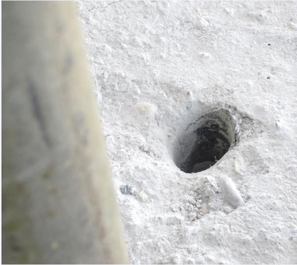
Vaina de embutido deformada hacia la zona de caída
