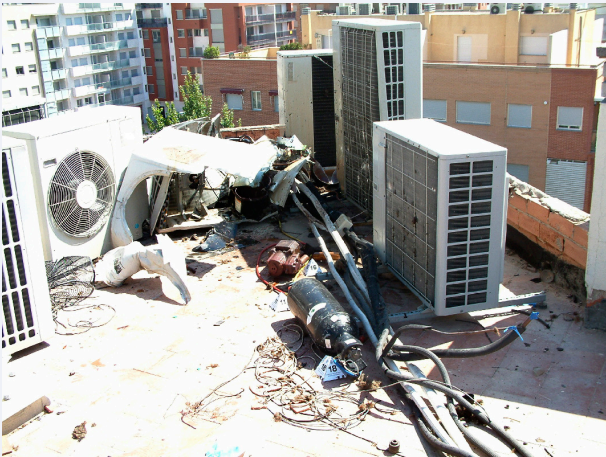
estado de la Unidad Exterior
