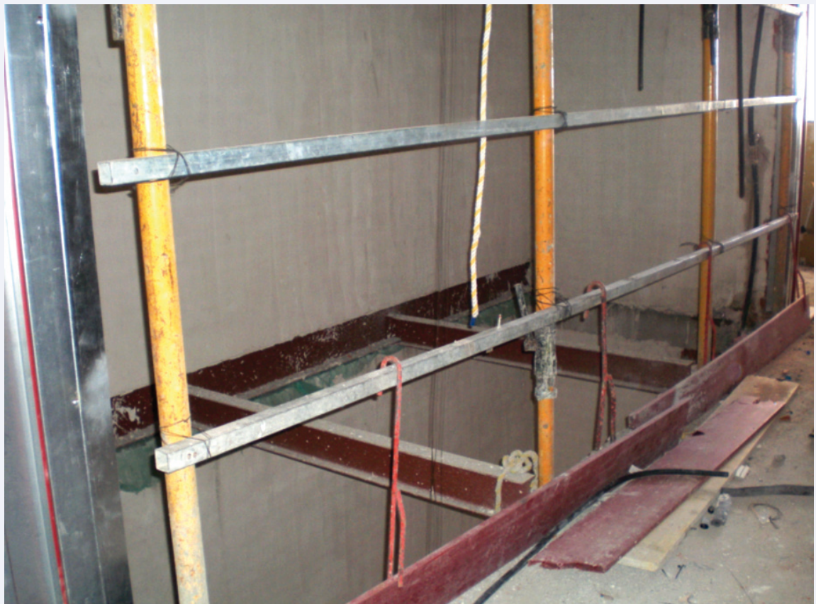
Se puede observar el hueco del ascensor donde existen dos vigas metálicas que dividen el mismo en tres partes. Las redes de protección estaban instaladas por debajo de dichas vigas
