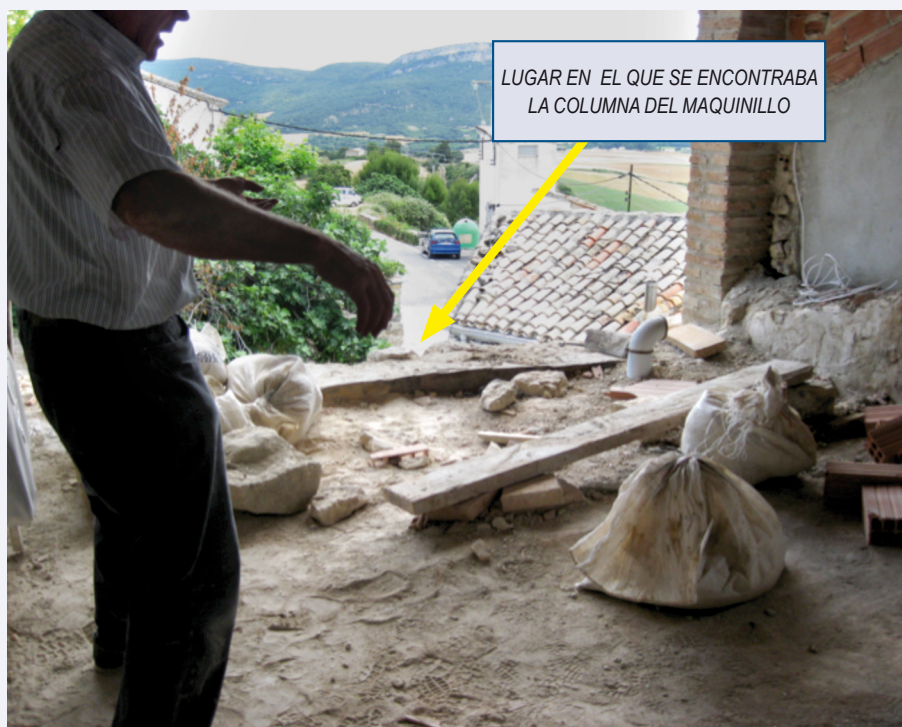
Vista desde el interior de la vivienda del forjado por el que cayó el accidentado
