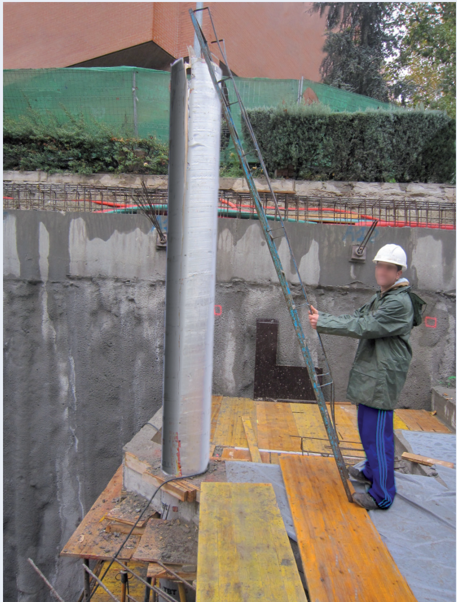
En la fotografía se aprecia el apoyo de la escalera y la zona de caída
