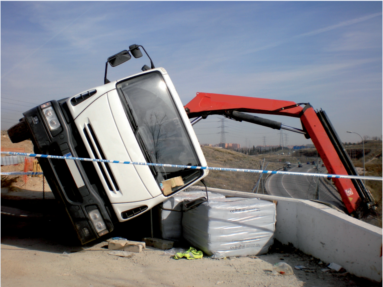
Grúa autocargante volcada sobre los palés. Entre la grúa y los palés quedó atrapado el trabajador
