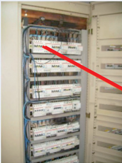
Armario Eléctrico e Interruptor Diferencial
