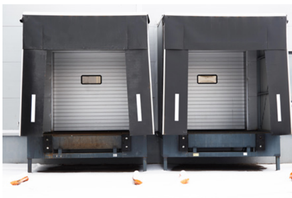
Exterior de muelle de carga con abrigos (color negro) y rampa de carga sobre bancada (superficie metálica).
