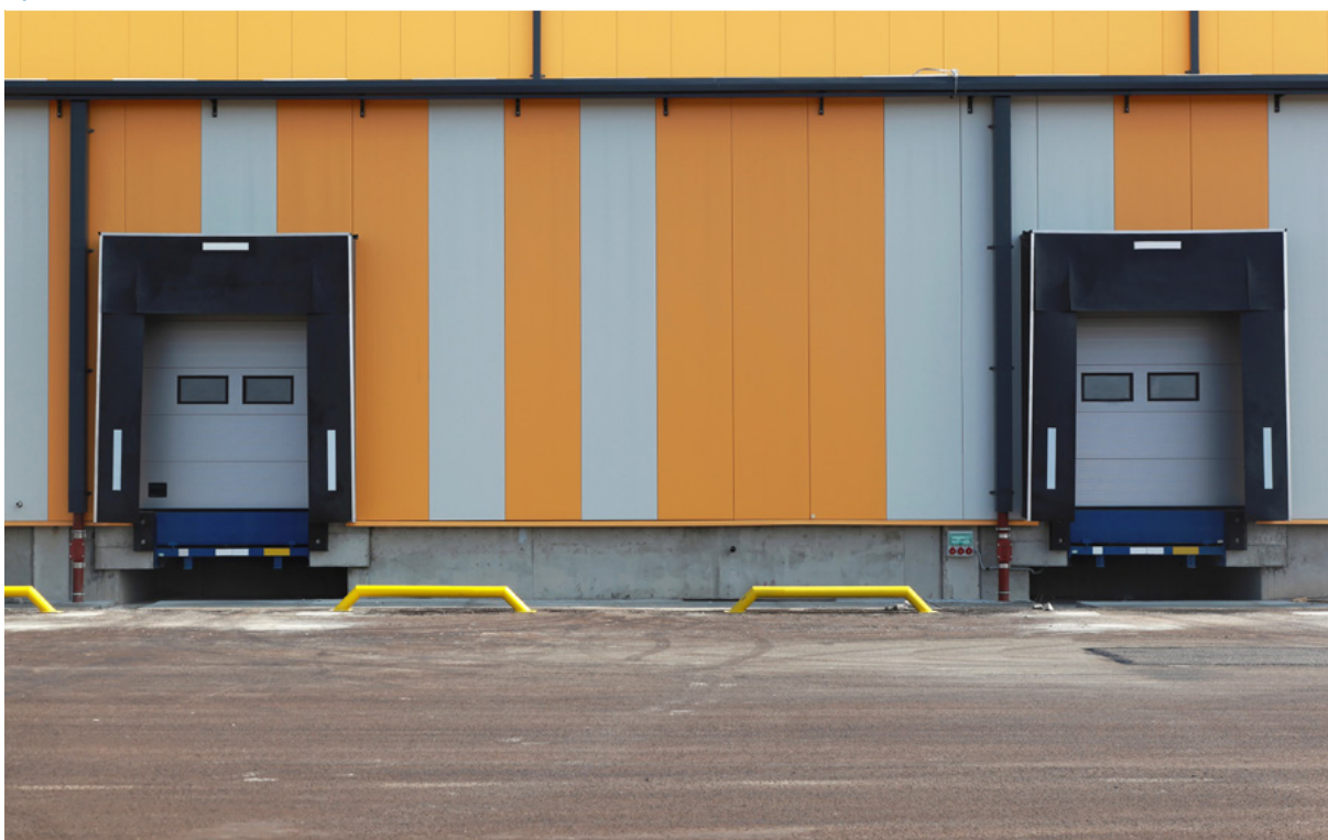
Vista exterior de rampas de carga (en color azul) instaladas bajo las puertas del muelle.
