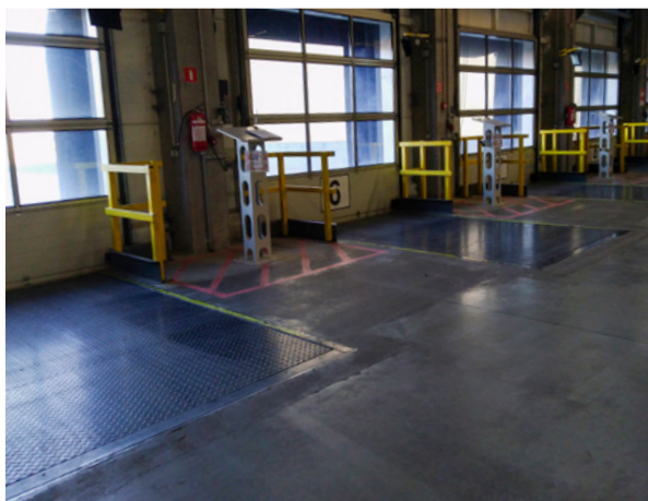
Vista interior de rampas de carga (superficies metálicas oscuras) instaladas sobre foso.
