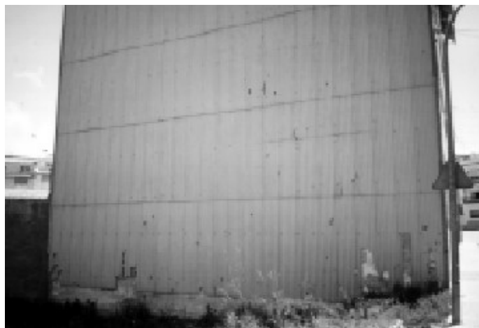
Figura 2. Detalle del estado de las placas de fibrocemento instaladas en un edificio
