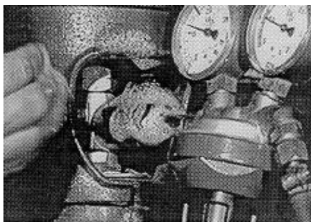
Fig. 7: Verificación de escape de gas con solución jabonosa
