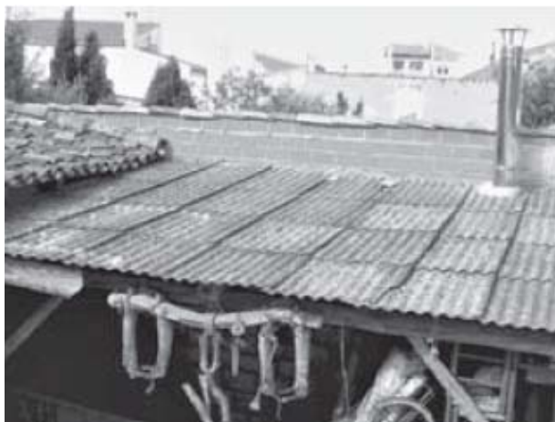
Figura 11 Cubierta de fibrocemento muy deteriorada
