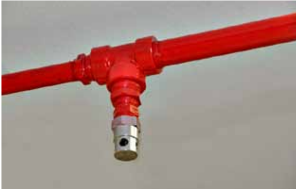
Figura 3. Difusor de descarga y canalización del gas
