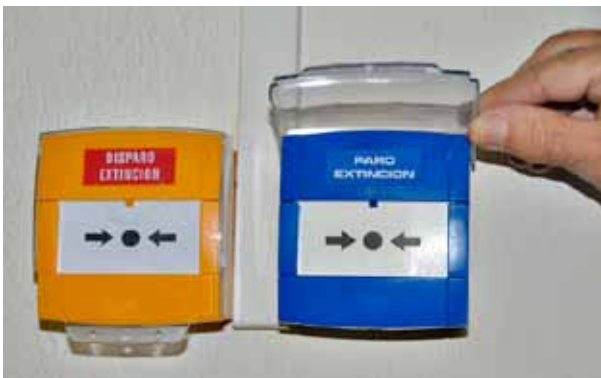
Figura 4. Pulsador de disparo manual del sistema (amarillo) y pulsador de bloqueo o anulación del disparo (azul)
