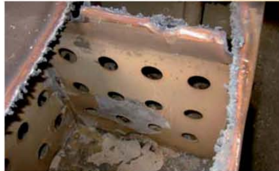
Sedimento y escombros en paredes y fondos de depósitos de agua. Fuente: ISPESL.
