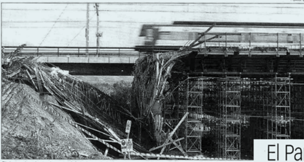
El derrumbamiento de parte del viaducto de la Autovía del Mediterráneo se cobró seis vidas (Granada)
